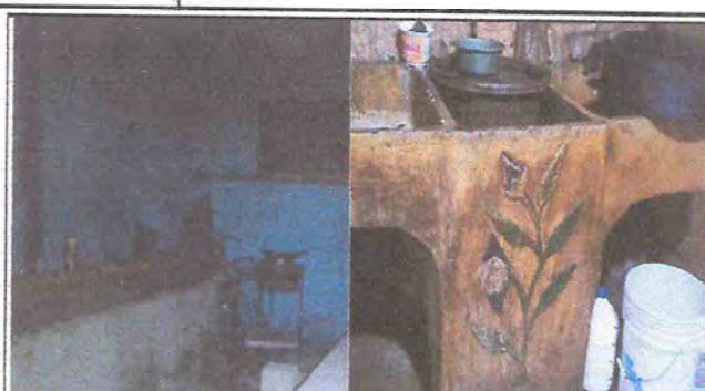
Foto 2: Polletones en mal estado, pila con filtraciones
