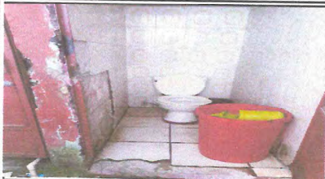
Foto 1: Inodoros en mal estado, piso y azulejos dañados
